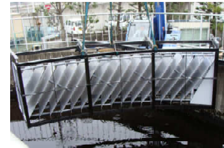
高速沈殿装置(傾斜盤)
